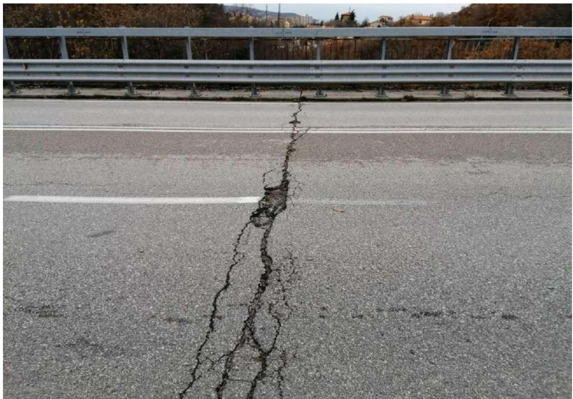
Fessura nel manto stradale in corrispondenza del giunto di costruzione.
