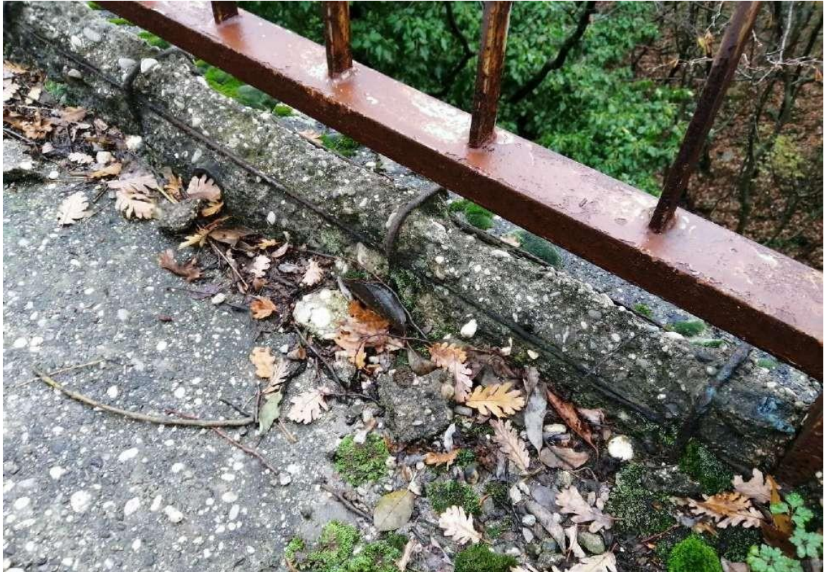
Ammaloramento della soletta laterale.
