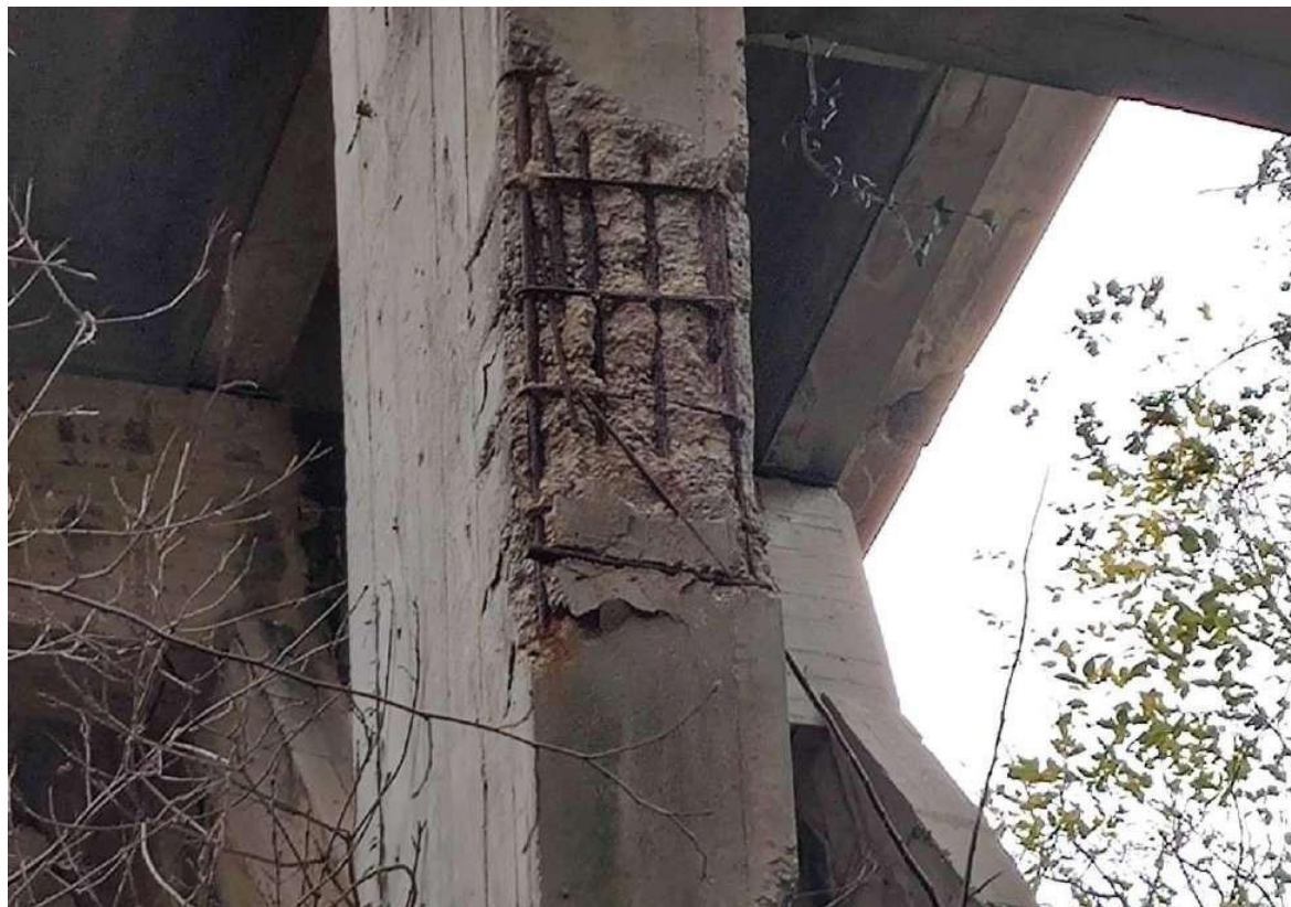
Ferri d'armatura esposti.
