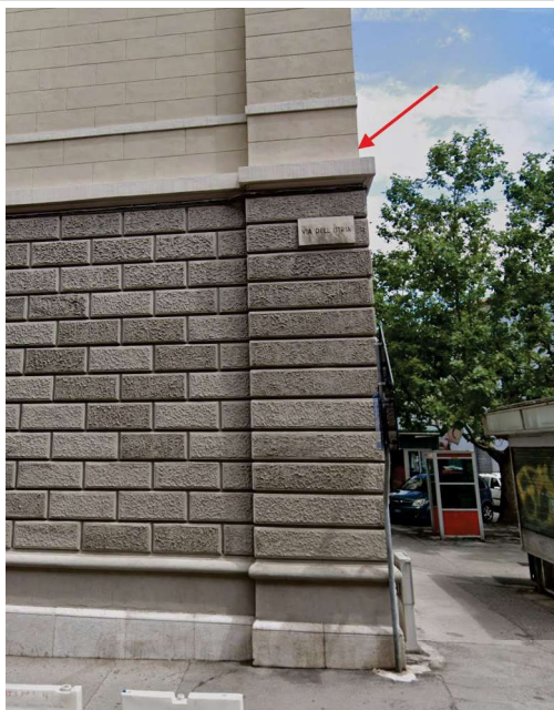
Percorso richiesto per il transito cavi UTP
